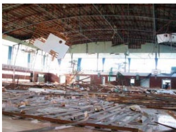
○天井や照明の落下
