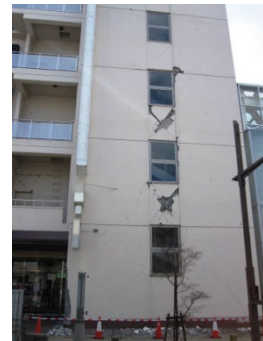
○連層壁のせん断ひび割れ
