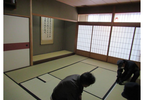
1階研修室 10帖 天井は落ちていないか。 照明・クーラーは落ちてないか。 ガラスは壊れていないか。
