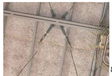
○破断した天井ブレース
