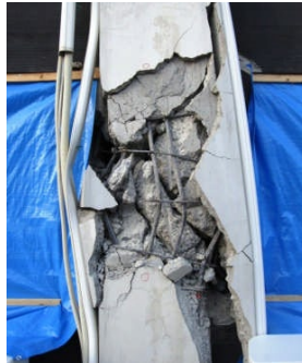
○短柱のせん断破壊
