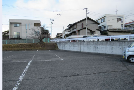
④ 駐車場道路 土砂崩れ
