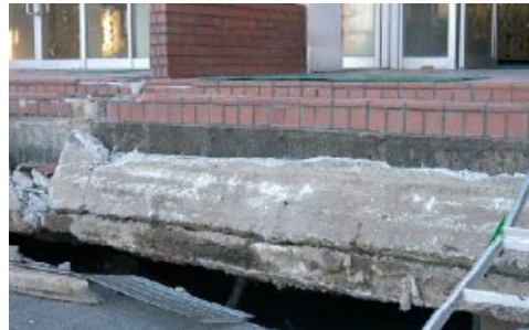
○地盤沈下による段差
