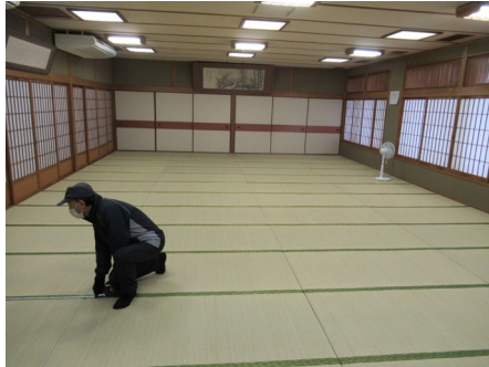
1階会議室 52帖 天井は落ちていないか。 照明・クーラーは落ちてないか。 ガラスは壊れていないか。
