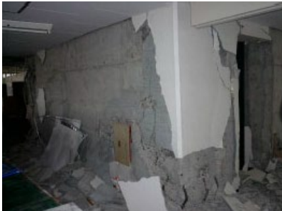
○耐力壁のせん断破壊
