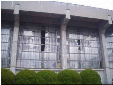
○ガラスの破損
