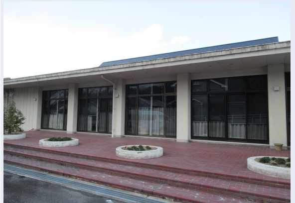
② 作業室南ガラスの破損
